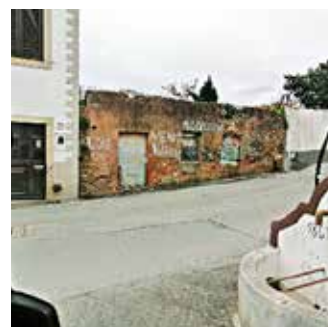
Figura 4 - Edifício em ruína
